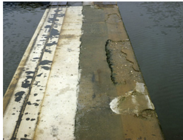
Bild 2: Schadhafte Instandsetzung mit organischen Dünnbeschichtungen
