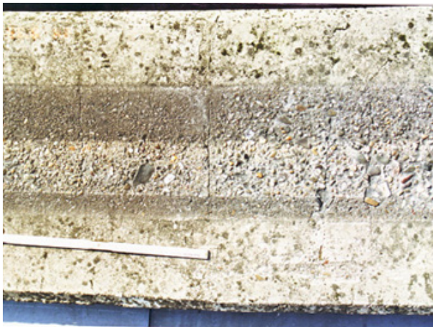
Bild 8: Abwitterung an einer Betonierfuge: Zustand 1999
