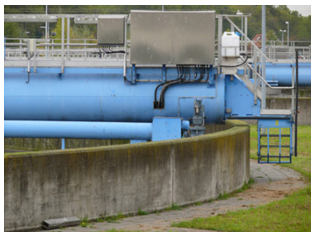
Bild 6: Gleiches Becken wie Bild 5: Betriebszustand
