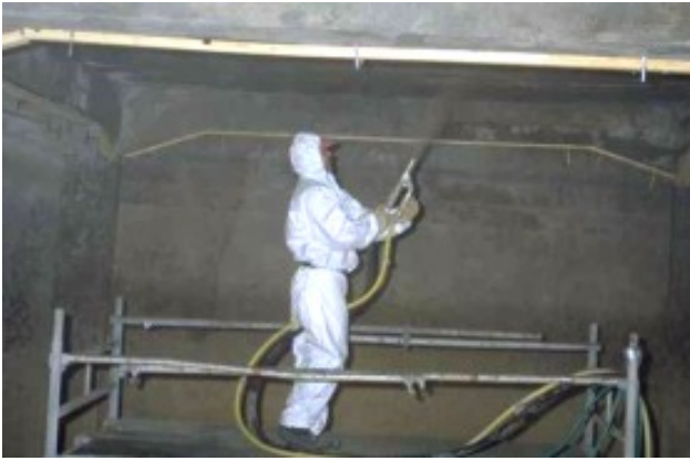
Bild 1: Typische Darstellung der Nassspritzapplikation in einem Trinkwasserbehälter mit TW20 in der Dichtstrom – Nassspritzapplikation mit der MAWO – Düse
