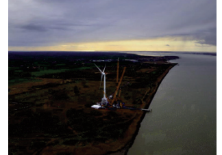
Alstom Haliade 150-6 MW
