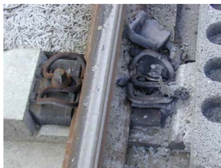
Abb. 3: Zerstörter Schienenstützpunkt und Schwellenhöcker nach Entgleisung im Umfahrungsbereich Melk ÖBB Bauart Fertigteilplatte Porr [9]
